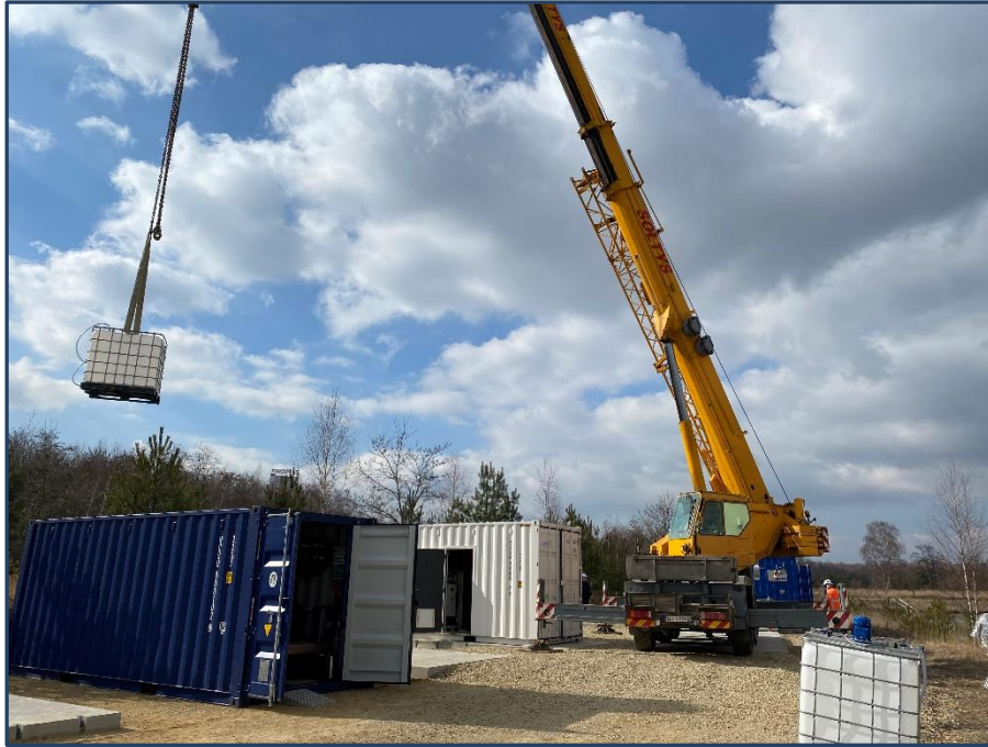
Εικόνα 1: Τοποθέτηση δεξαμενών IBC
